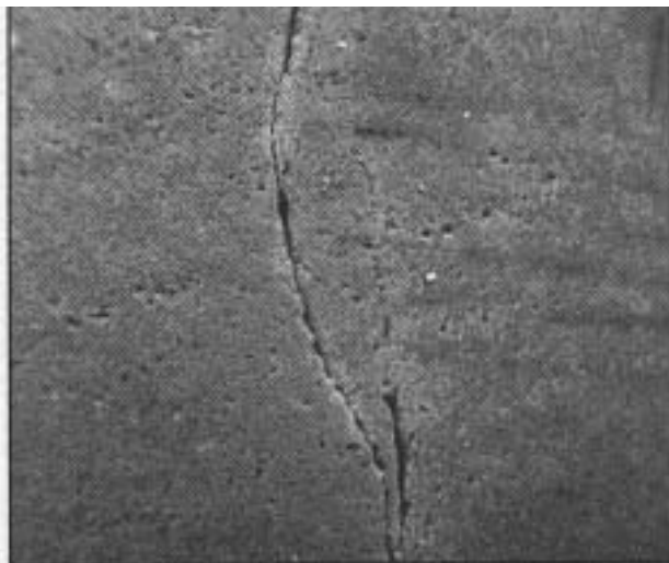
Рис. 3 – Поверхность и направление трещиноватости пористого бетона в вентиляционном канале.
